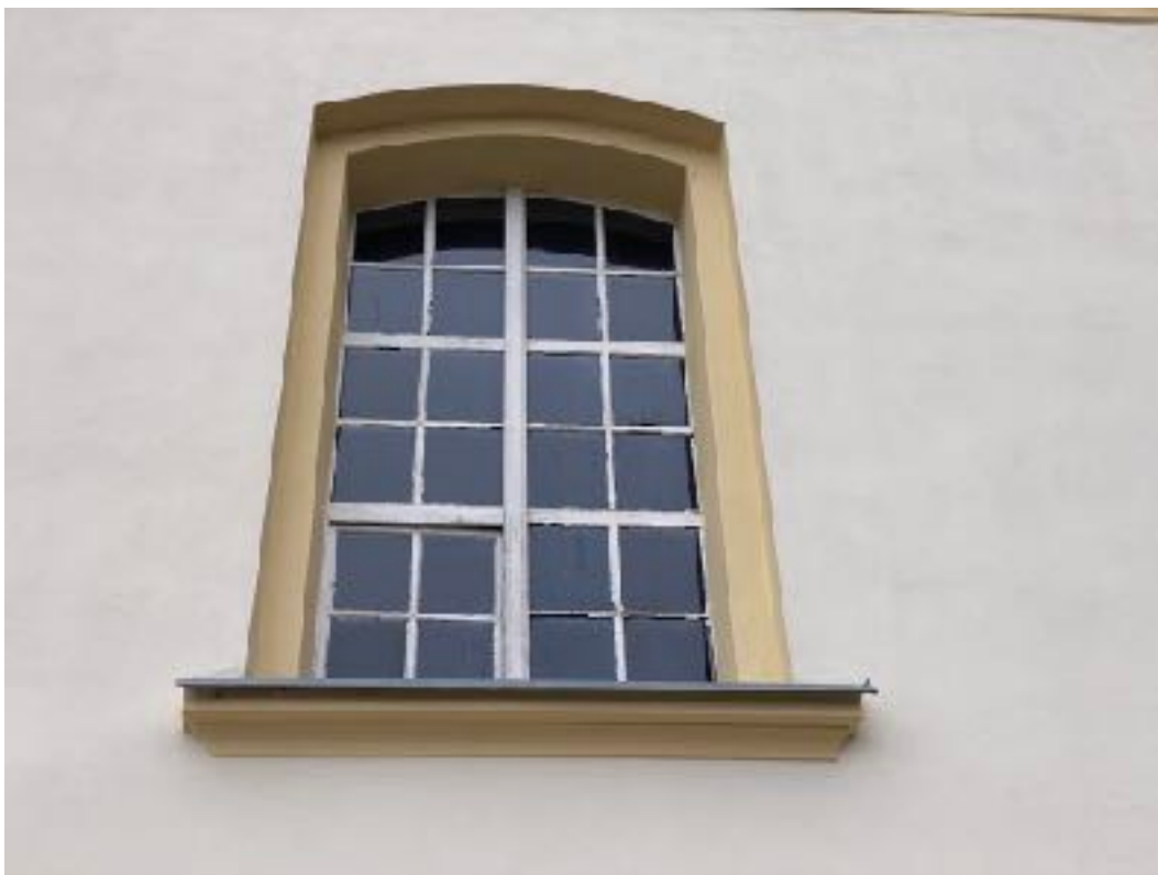
Fot. 9 Okno nr 11 w elewacji południowej . Widoczna niedomykająca się kwatery rozwiewna.
