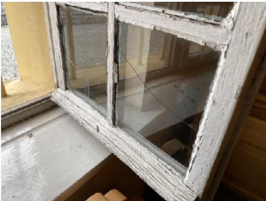
Fot. 7 Zbliżenie na stan zachowania drewna okna nr 2 w elewacji zachodniej. Widoczne ubytki w kicie okiennym oraz pęknięcia szyby.
