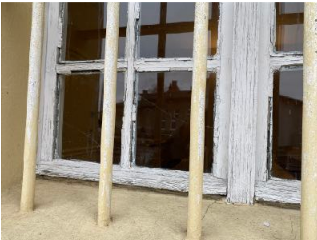
Fot. 6 Zbliżenie na stan zachowania drewna okna nr 2 w elewacji zachodniej. Widoczne ubytki w kicie okiennym oraz pęknięcia szyb.
