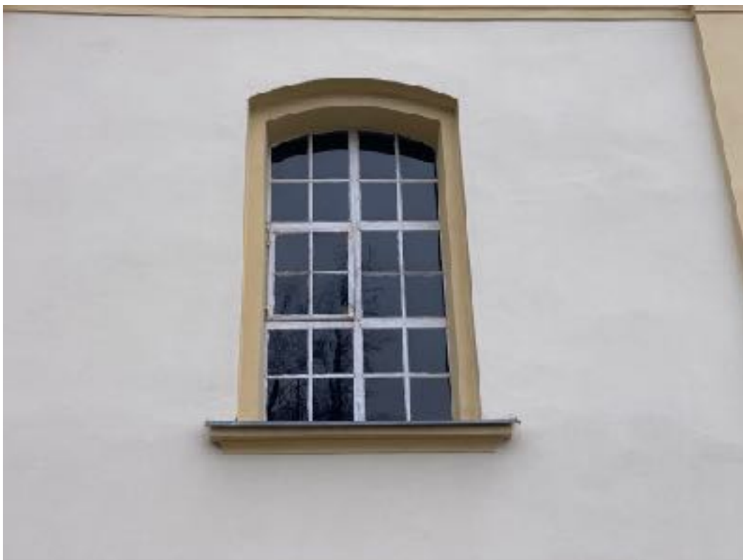
Fot. 13 Okno nr 3. Widoczna rozwiewna kwatera otwierająca się na zewnątrz oraz brak profilowania pionowego słupka.
