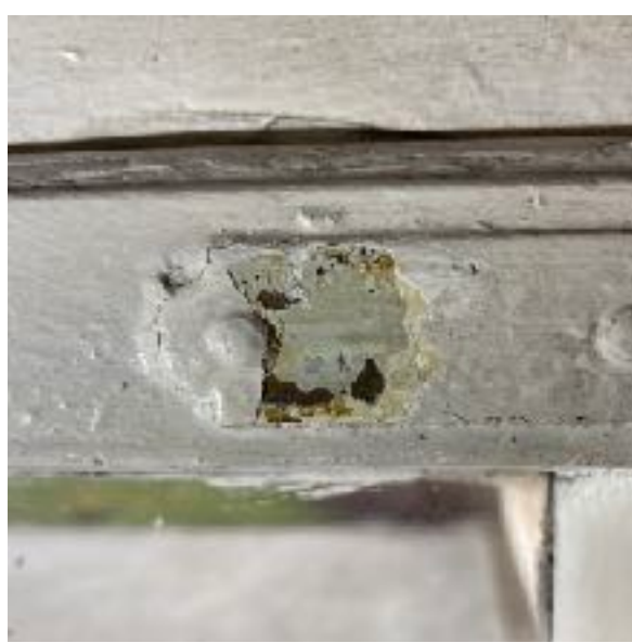
Fot. 6 Odkrywka w obrębie okucia ukazująca bezpośrednio na metalu powłokę malarską w kolorze mlecznej szarości RAL 7047
