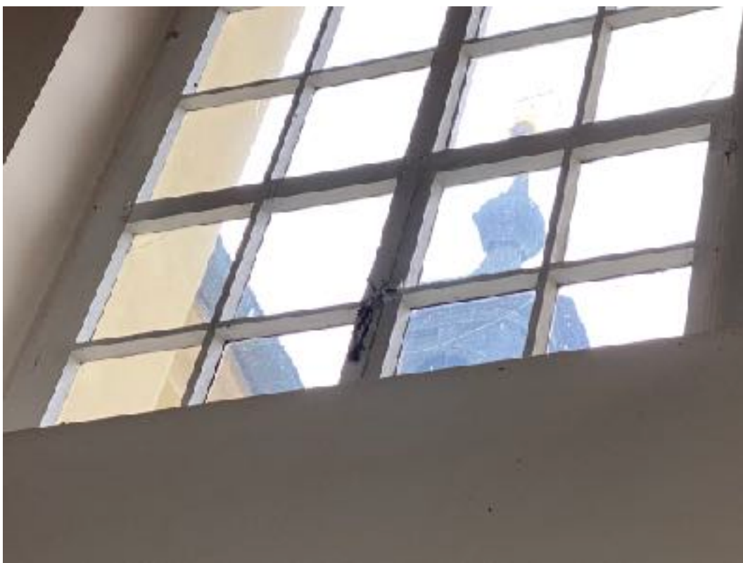
Fot. 11 Okno nr 11 od strony wewnętrznej. Widoczny uszkodzony mechanizm zamykający kwaterę rozwiewnej.
