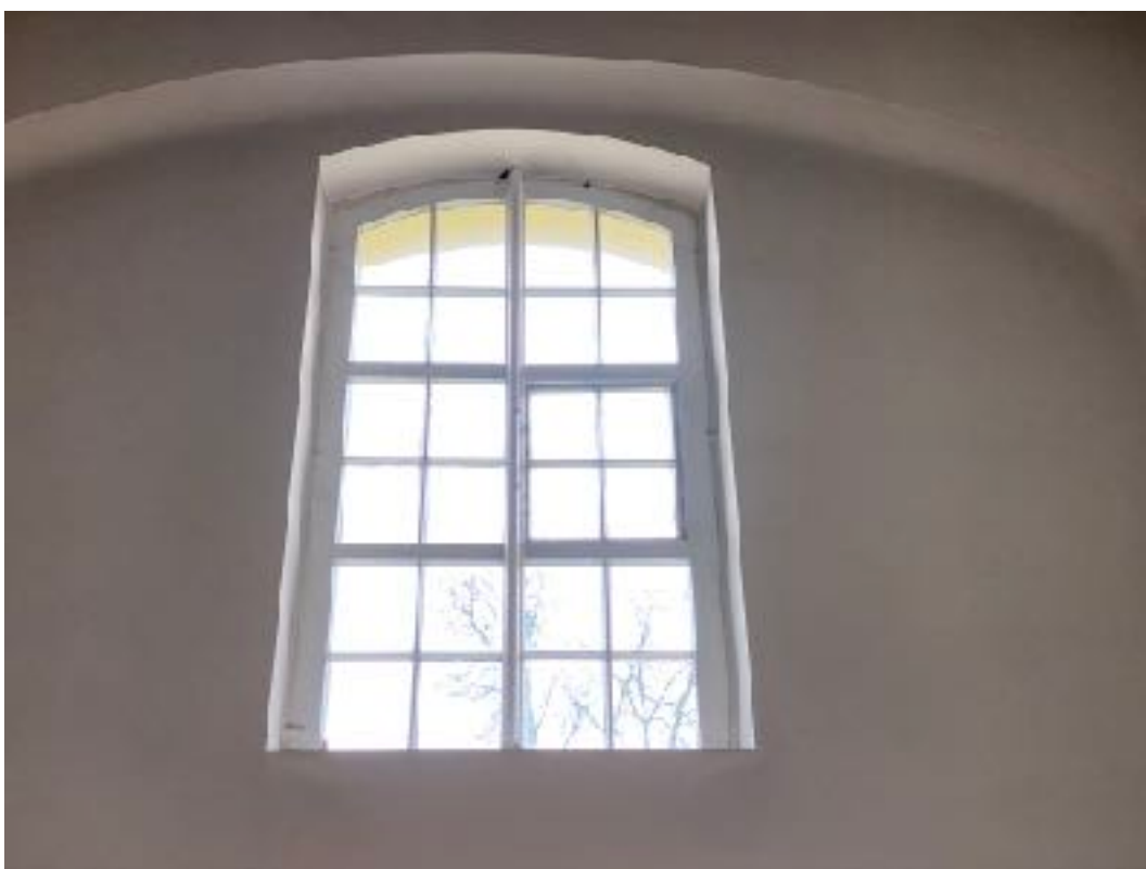
Fot. 14 Okno nr 3. Widoczny pionowy, profilowy słupek z wałkiem od strony wewnętrznej. Awers okna stanowiący obecnie rewers.
