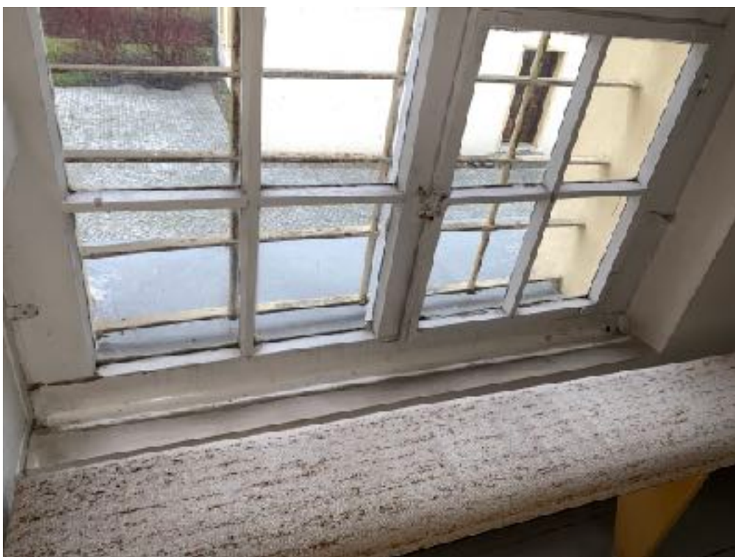
Fot. 12 Zbliżenie na metalową rynienkę podokienną na skropliny w oknie nr 5. Widoczny uszkodzony mechanizm zamykający kwaterę rozwiewnej.
