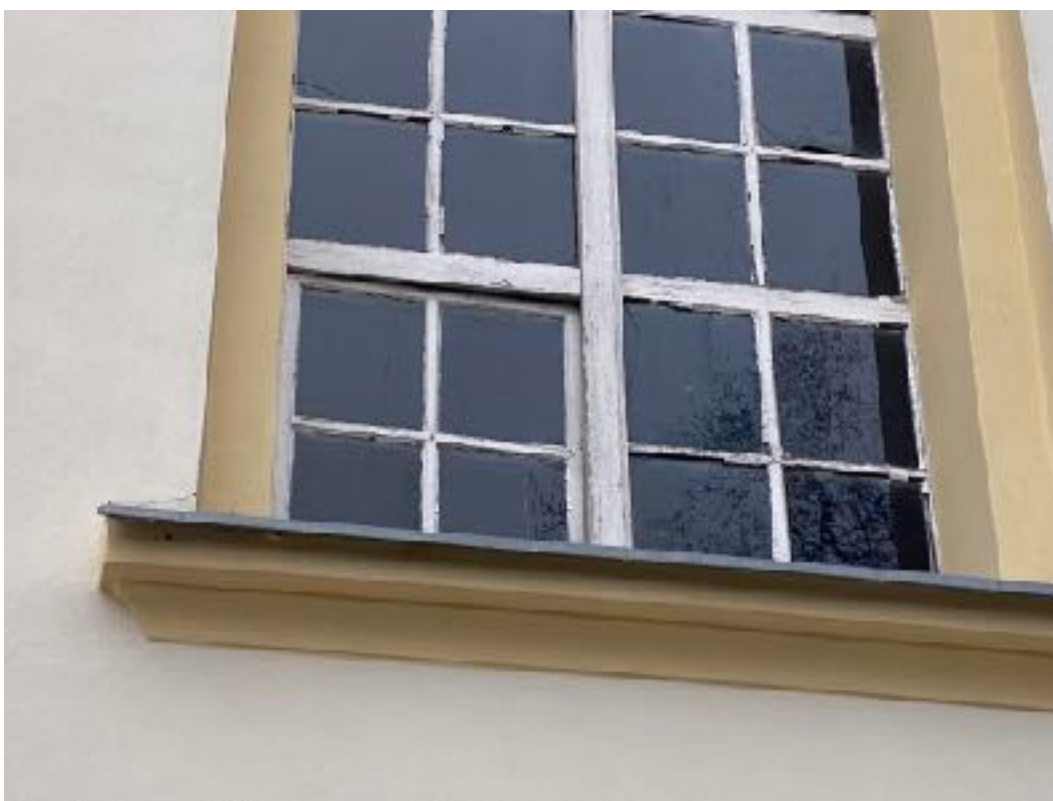
Fot. 10 Okno nr 11 w elewacji południowej . Zbliżenie na niedomykającą się kwaterę rozwiewną. Widoczne ubytki w kitach okiennych i pęknięte szyby.
