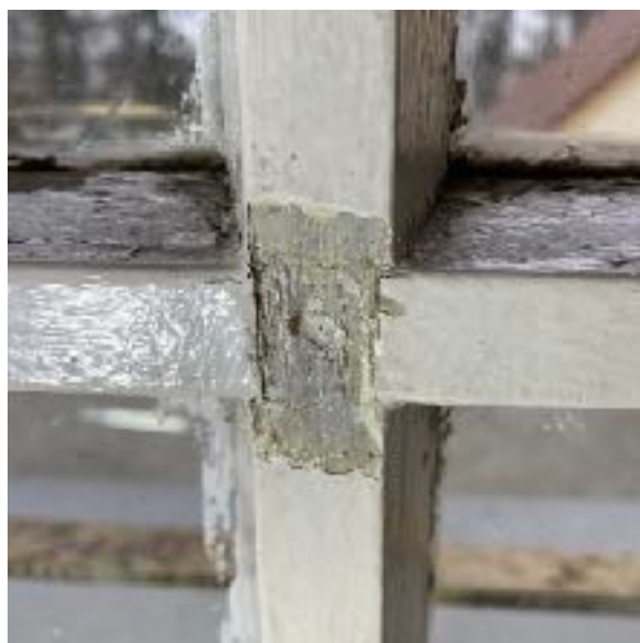
Fot. 5 Odkrywka w obrębie szprosów ukazująca bezpośrednio na drewnie powłokę malarską w kolorze mlecznej szarości RAL 7047
