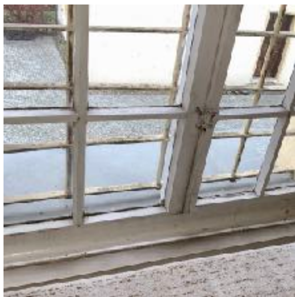
Fot. 7 Zbliżenie na detal okna - widoczny prostopadłościenny szpros, pozostałość po mechanizmie zamykającym rozwiewną kwaterę oraz metalową rynienkę pod oknem na skropliny.
